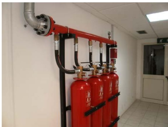
Système de protection anti-incendie au gaz HFC 227 ea (FM200) d'une salle serveur
